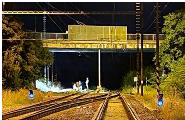
Havarijný stav mosta v Seredi
